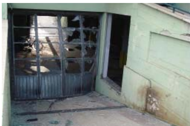
Il garage incendiato della Croce Verde di Viareggio
